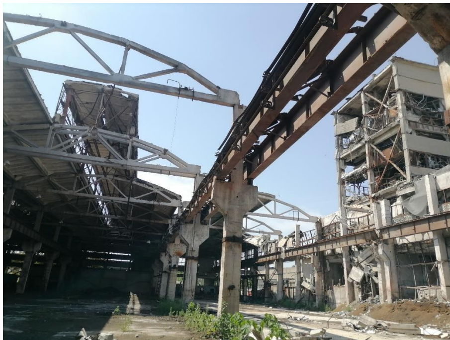
Рис. 5. Руйнування конструкцій будівлі (внаслідок ракетного удару)
