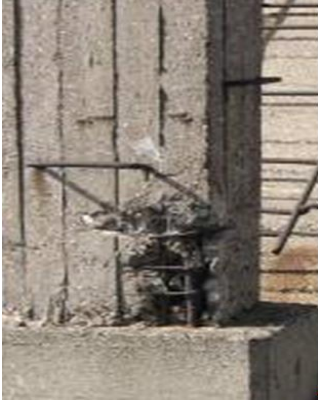
Рис. 2. Виявлені дефекти опор мостових споруд
