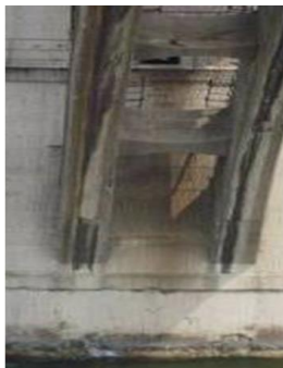
Рис. 3. Виявлені дефекти мостових споруд
