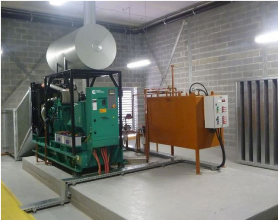
Рис. 9.13. Розміщення ДЕС безпосередньо в межах захисної будівлі
