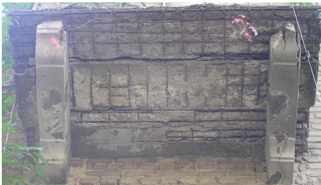
Рис. 3.35. Аварийное техническое состояние
