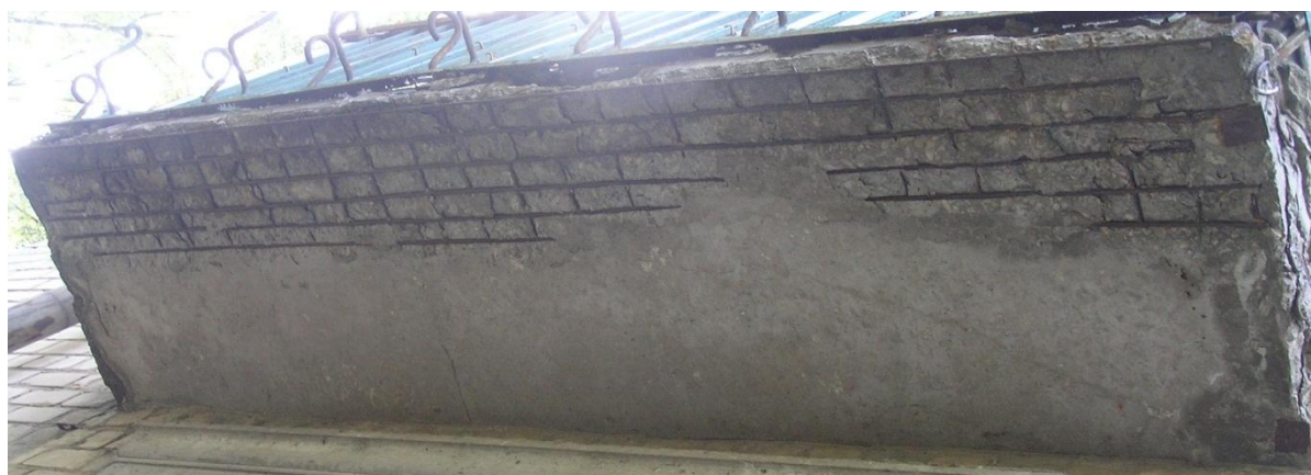
Рис. 3.36. Аварийное техническое состояние
