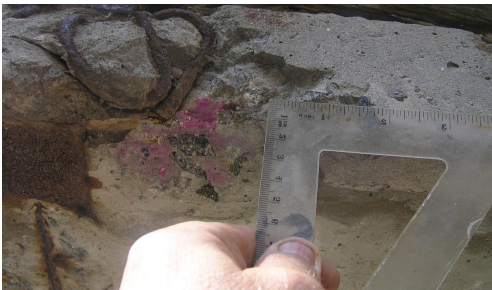
Рис 3.29 Определение глубины карбонизации плиты балкона
