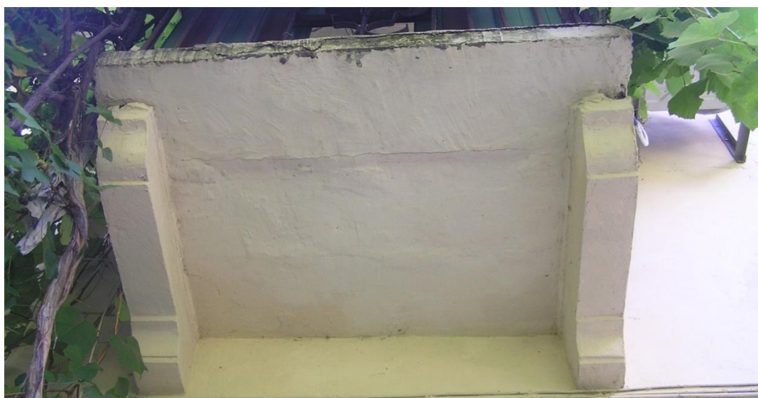
Рис. 3.31. Нормальное техническое состояние
