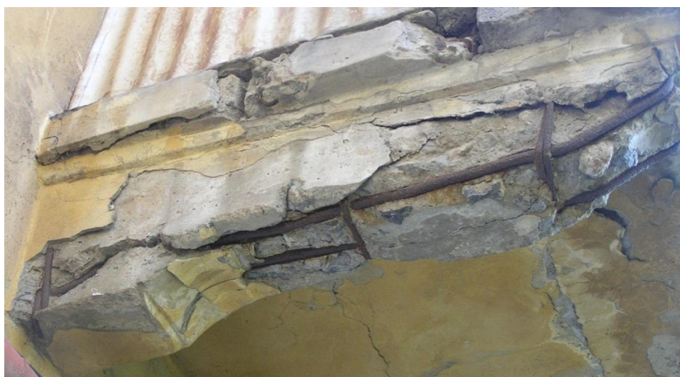
Рис. 3.34. Аварийное техническое стояние
