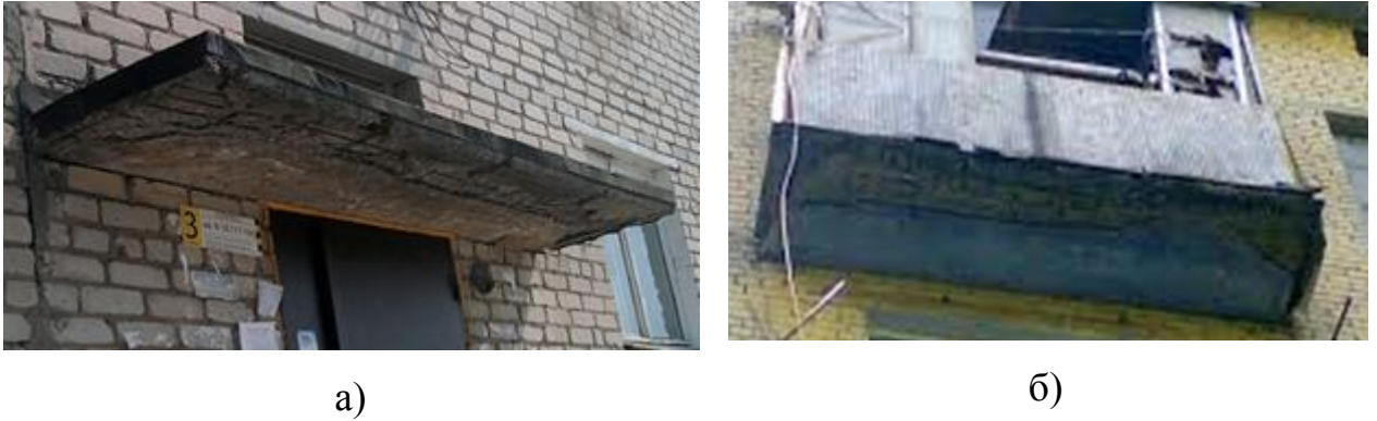
Рис. 1.3. Разрушение бетона защитного слоя с оголением и коррозией арматуры: а) козырька над входом жилого дома; б) балконной плиты.
