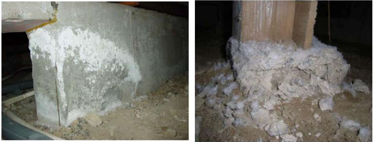
Рисунок 1.1 - Ілюстрація бетону, ушкодженого внаслідок сульфатної корозії
