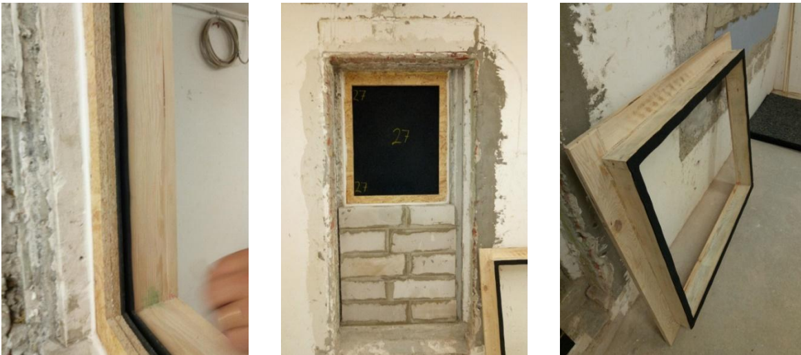
Рис. 1, 2, 3. Установка звукоізоляційних панелей під час проведення експерименту / Fig. 1, 2, 3. Installation of soundproof panels during the experiment
