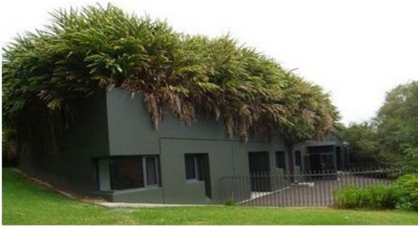
Рис..4. Интенсивна зелена покрівля на плоскому даху / Intensive green roofs on flat roof
