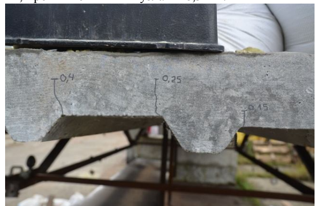
Рис. 13. Тріщини в плиті (КСБ-3)
