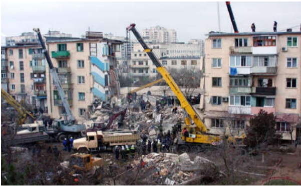
Рис. 3. Схема розстановки та переміщення машин у процесі розбирання руйнувань (Євпаторія, 2008 р.) традиційною будівельною технікою
