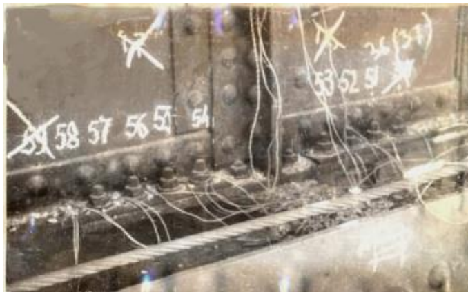
Рисунок 3.1 – Загальний вид установки тензорезисторів на поздовжній лівій балці Б1 в сполученні з поперечною балкою П2
