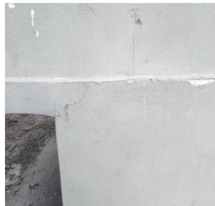
Рис. 11. Механічні пошкодження системи утеплення на стиках несних конструкцій
