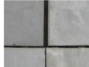
Рис. 15. Вади під час влаштування стику панелей на будівельному майданчику
