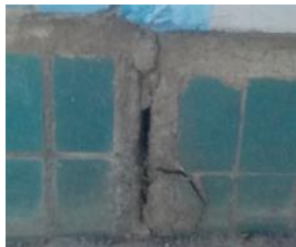
Рис. 2. Пошкодження стику стінових панелей (неремонтованого)
