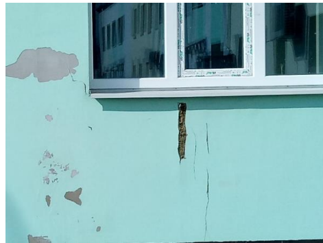
Рис. 10. Механічні пошкодження системи утеплення
