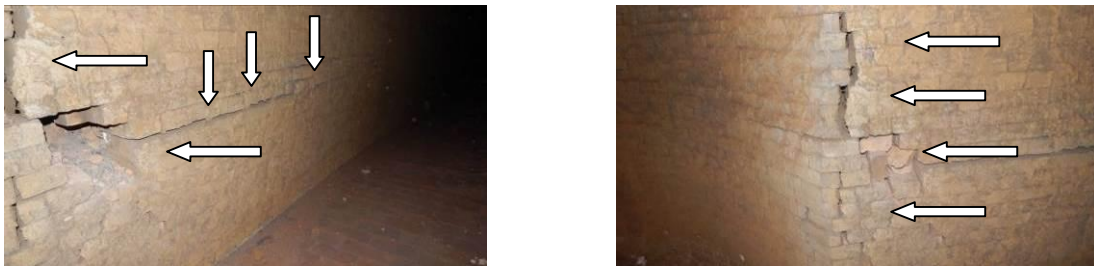
Рис. 1. Тріщини у футеруванні стін газоходу
