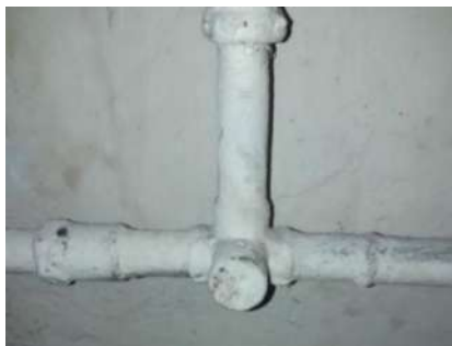
а) відсутня регулювальна пробка крана
