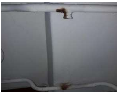
г) підтікання системи опалення
